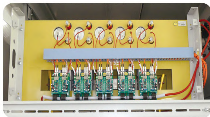
高压 TSC 晶闸管阀组
